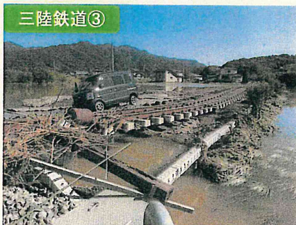
路盤・道床流出（津軽石～弘川）
