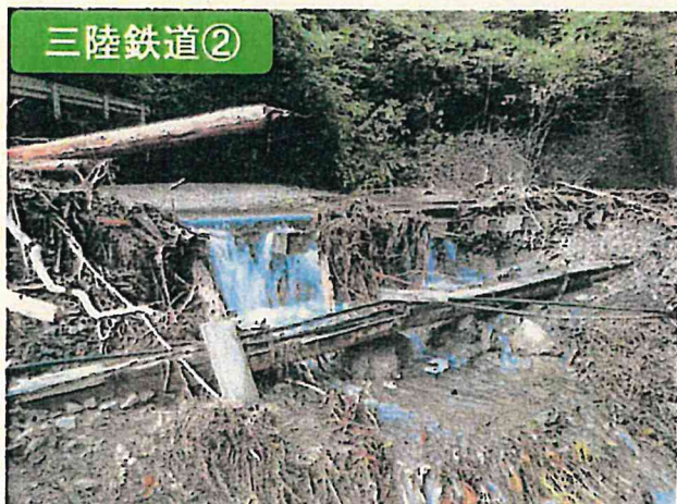
土砂流入、道床流失（普代～白井海岸）
