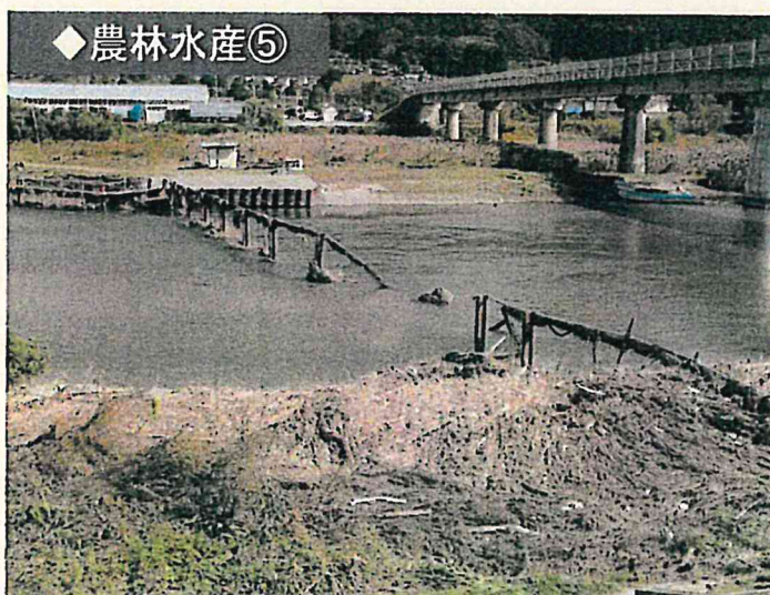
サケ採捕施設の破損（大船渡市）
