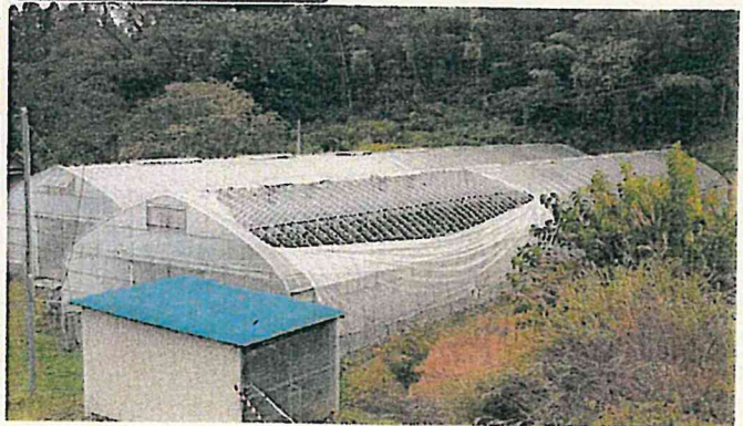
ビニールハウスの破損（一関市）
