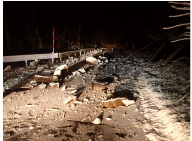
図2 一般県道安家玉川線の落石状況
